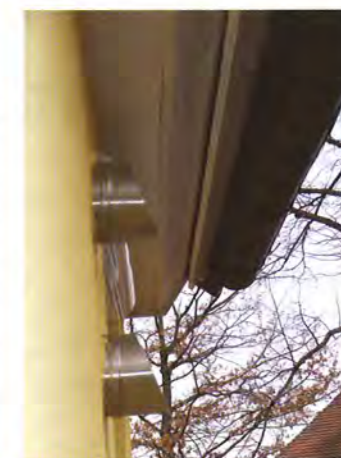
Die Stutzen für die Frisch- und Abluft wurden in die Neue Fassadengestaltung integriert.
