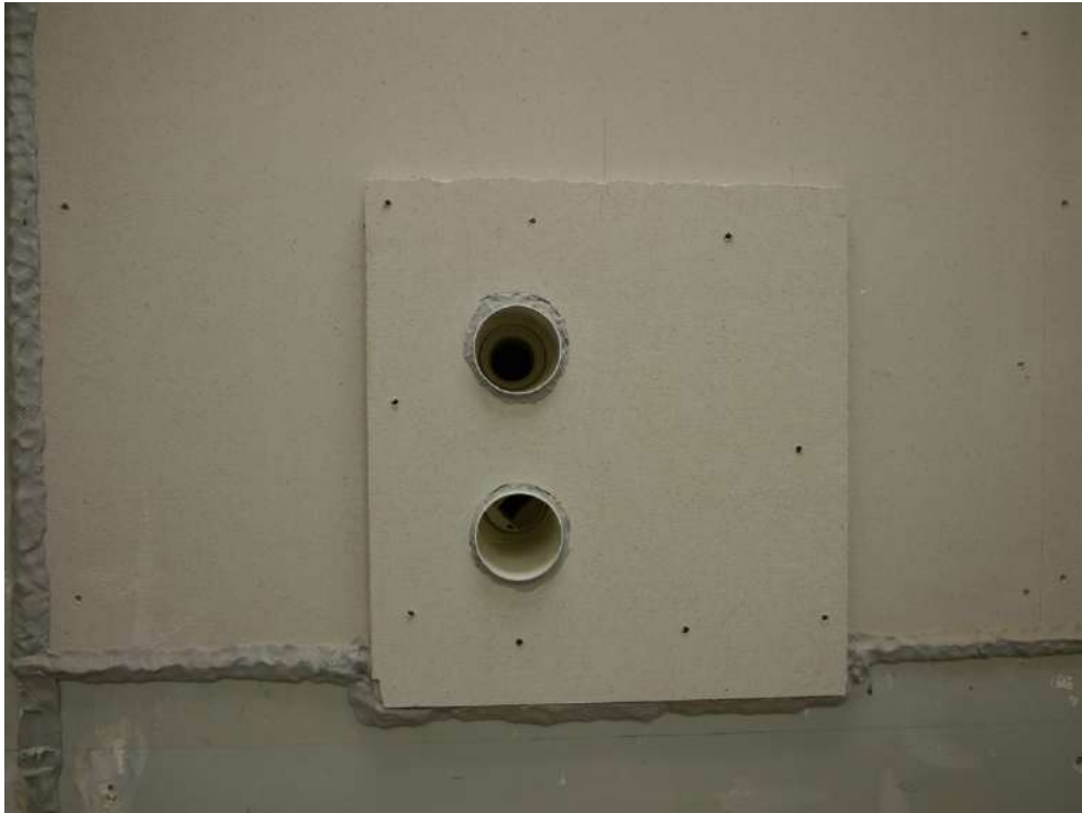
Abbildung C.1. Variante Standardfassadenabschluss ES: Lüftungsöffnungen außenseitig (Außenluft oben, Fortluft unten), Fassadenabschluss noch nicht montiert.
