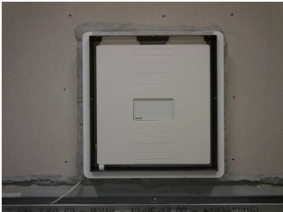
Abbildung C.8. Ansicht Lüftungsgerät innenseitig vor Montage der Vorsatzschale, Abdichtung zum Prüfstand vollständig.
