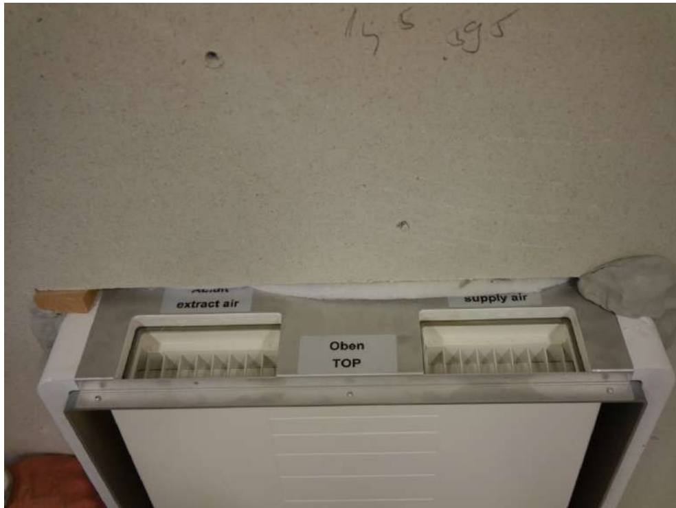
Abbildung C.7. Lüftungsgerät innenseitig mit Lüftungsöffnungen (Zu- und Abluft) vor Montage der Vorsatzschale sowie der Anschlusskanäle, Abdichtung zum Prüfstand noch unvollständig.
