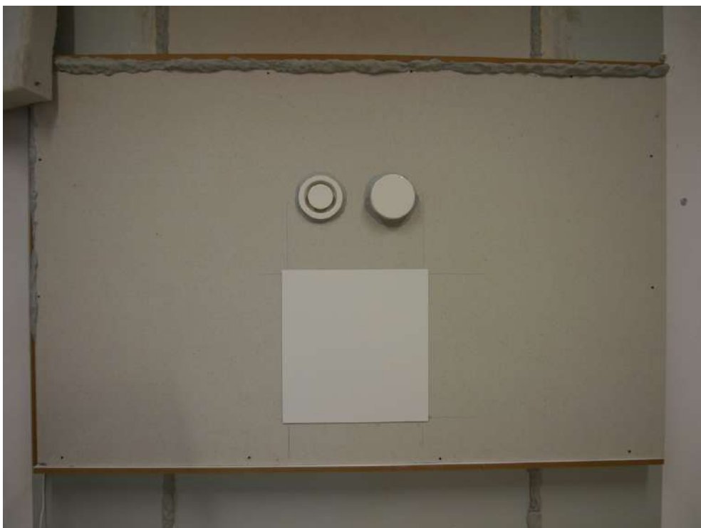
Abbildung C.12. Ansicht Lüftungsgerät innenseitig: prüffertig mit geschlossener Vorsatzschale, Tellerventil ABL bzw. ZUL und Abdeckung U 2 montiert.
