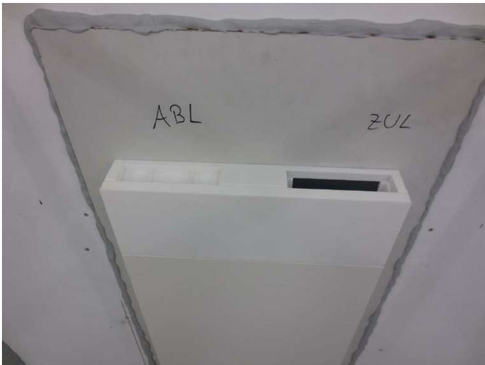
Abbildung E.16. Mehr-Raum-Variante mit Kanalanschluss ABL-seitig: Ansicht Innenseite oben mit geöffneter ZUL-Öffnung (prüffertig).
