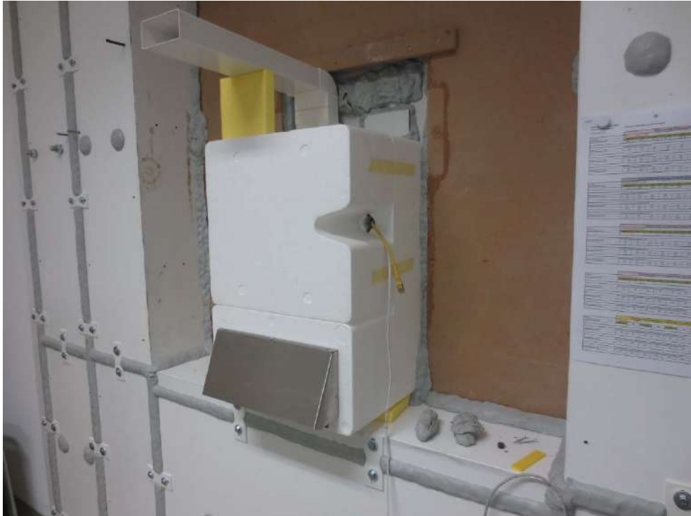
Abbildung E.5. Mehr-Raum-Variante mit Kanalanschluss ZUL-seitig: Ansicht Außenseite (prüffertig). Kanalanschluss ZUL nach außen (Senderraum) geführt.
