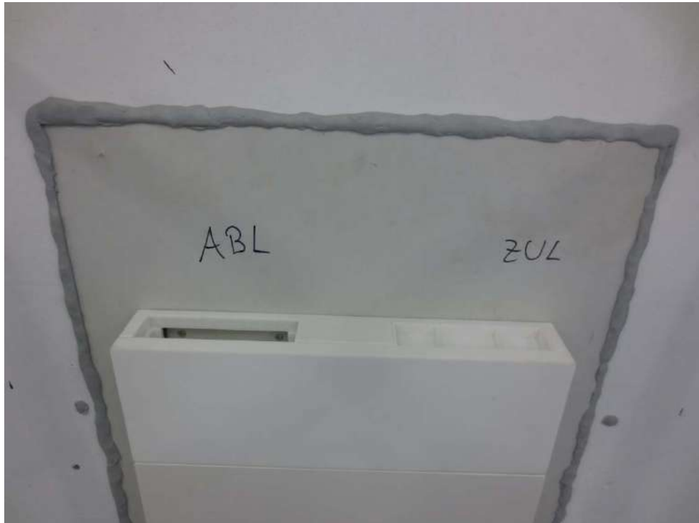
Abbildung E.17. Mehr-Raum-Variante mit Kanalanschluss ZUL-seitig: Ansicht Innenseite oben mit geöffneter ABL-Öffnung (prüffertig).
