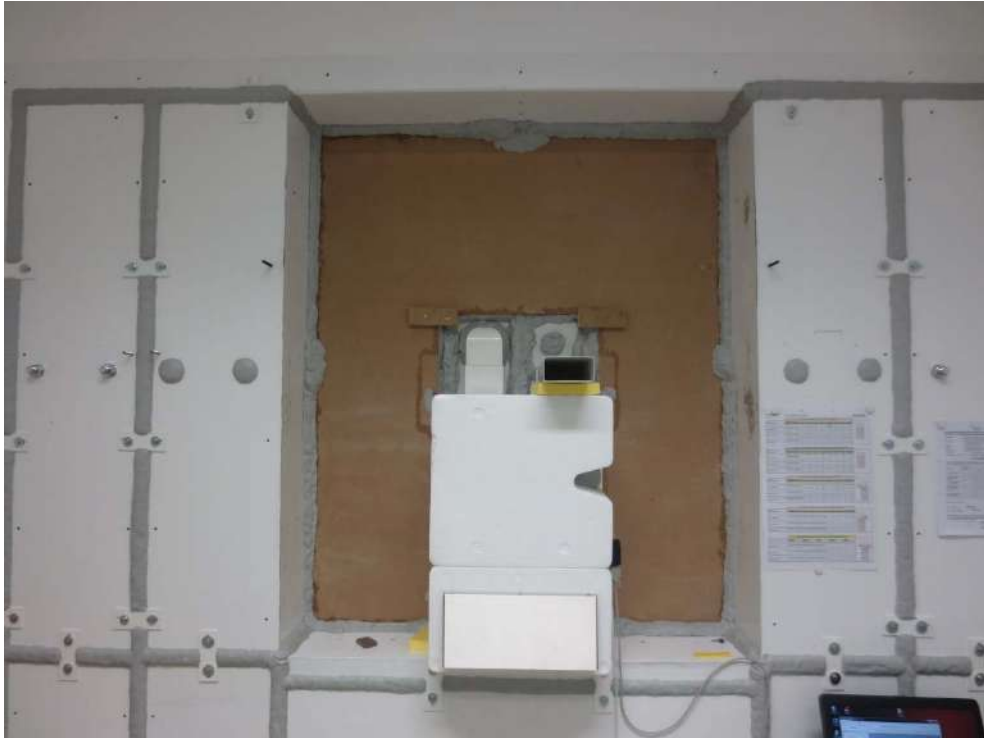
Abbildung D.5. Prüfvariante mit Kanalanschluss ABL-seitig: Frontalansicht Außen-seite (prüffertig). Kanalanschluss ABL nach außen (Senderraum) geführt.
