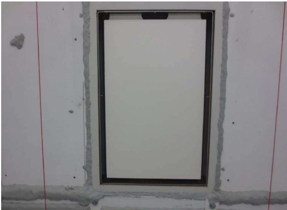
Abbildung D.2. Lüftungsgerät in Trockenbaublende montiert: Ansicht Innenseite noch ohne Abdeckung U 2 .
