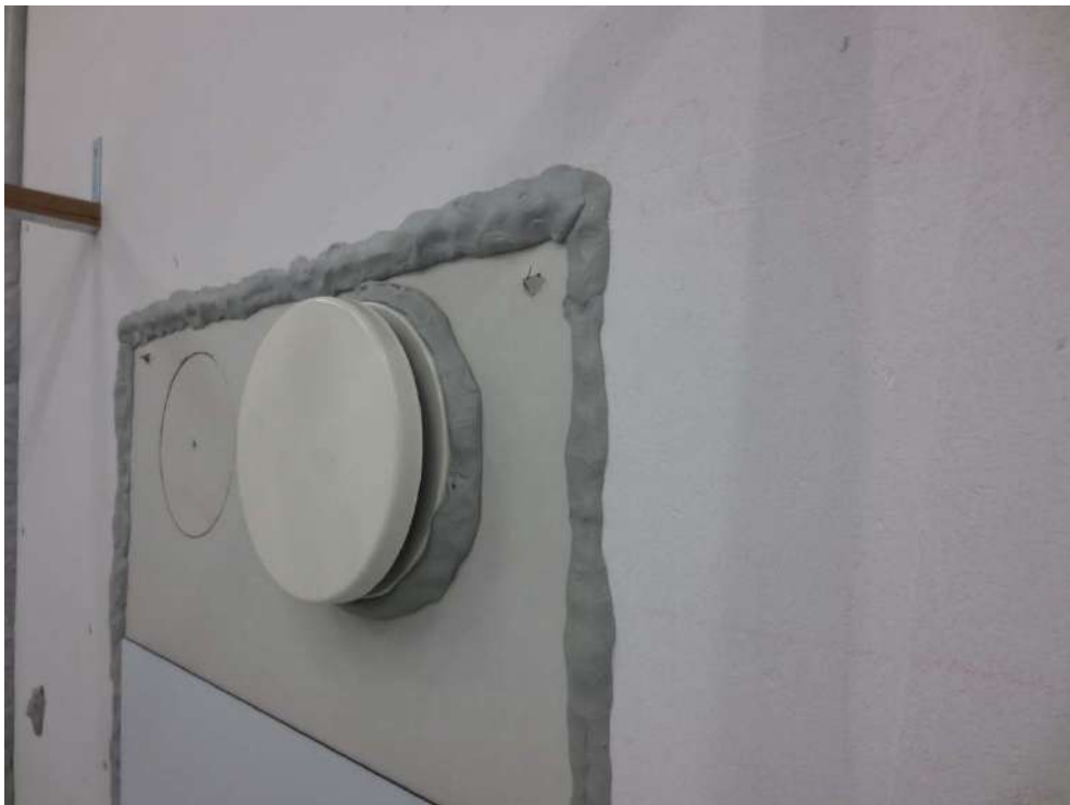
Abbildung D.10. Prüfvariante mit Kanalanschluss ABL-seitig: Ansicht Innenseite oben mit ZUL-Öffnung (prüffertig).
