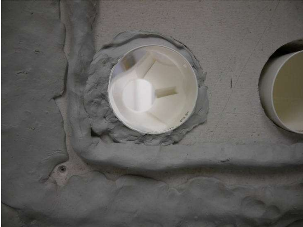
Abbildung B.3. Durchführung der Rohre zu den Außenöffnungen durch die Trockenbaublende im Fensterprüfstand; links mit umlaufender Abdichtung, rechts noch ohne Abdichtung.
